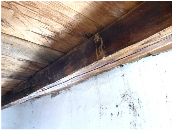
1. fotó FF-2 földmgerenda függőleges repedése
