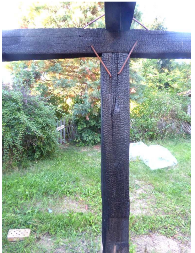
11. fotó O-15 pillér belső oldali köbösen, hullámosan beégett felső része
