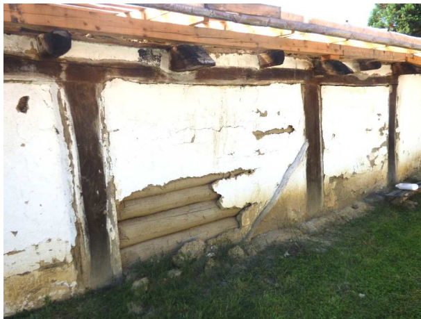
8. fotó Tisztaszoba K-i oldali 2. szakasz paticsfal vakolat leválás
