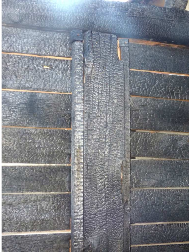
12. fotó F-1 födémgerenda, Ny-i oldali deszkafal, O-3 pillér köbös beégése és átégése
