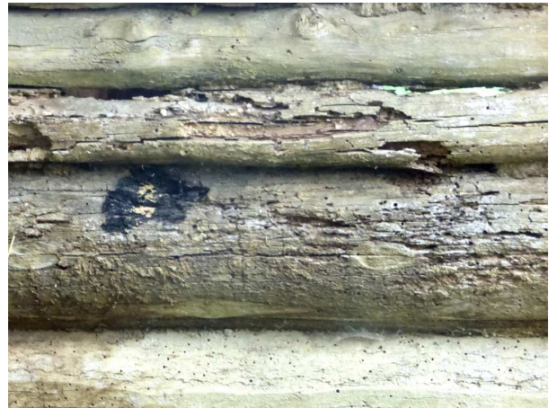
15. fotó Istálló É-i külső vakolat nélküli paticsfal, erősen rovarrágott, erősen korhadt felülete
