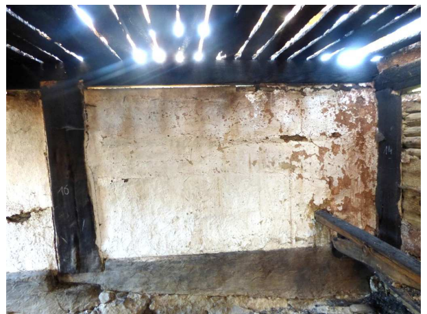
16. fotó Istálló teljesen szétégett födémgerendák fölötti deszkaburkolata
