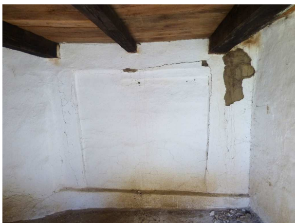
9. fotó Konyha K-i fal fapillérek közötti paticsfal repedései
