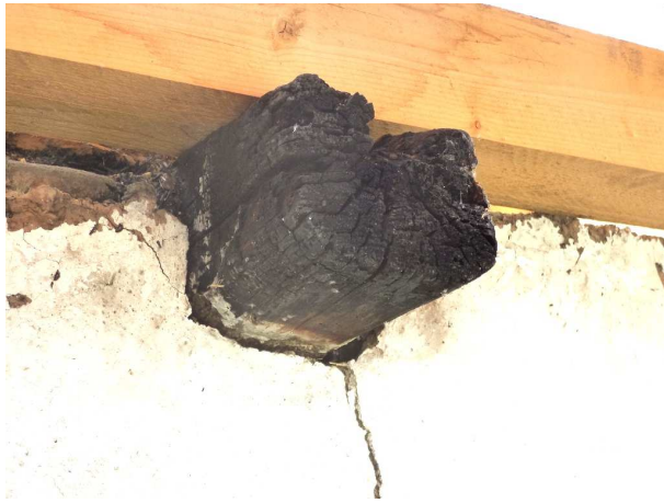
7. fotó FF-12 teljesen beégett fődémgerenda vég a K-i oldalon
