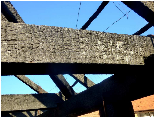
13. fotó Nytított szín födémgerenda oldalsó köbös beégése
